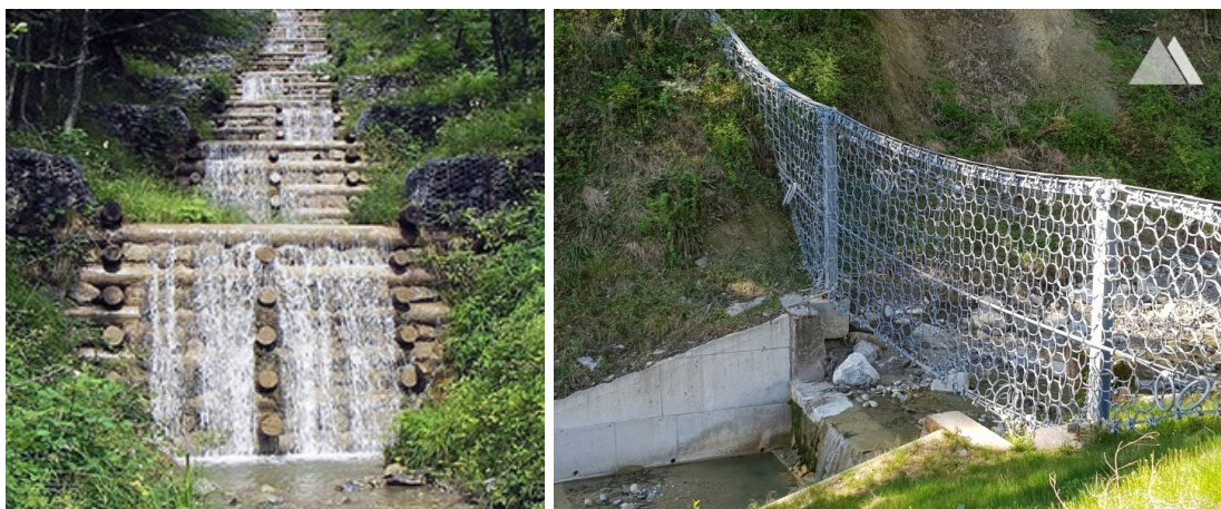
Figur 4-1 Venstre: Check dams laget av tømmer (Foto: WSL, Sveits). Høyre: Eksempel på Check dam kombinert med fangnett, fra Brendenbach, Sveits (Foto: Geobru gg)
