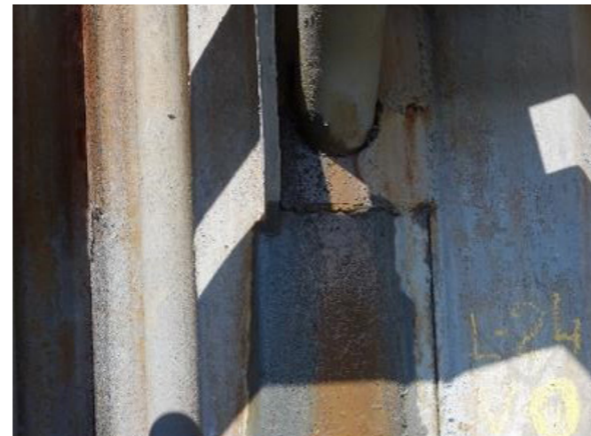
Figur 4: Lekkasje staggjennomføring utvendig svetting
