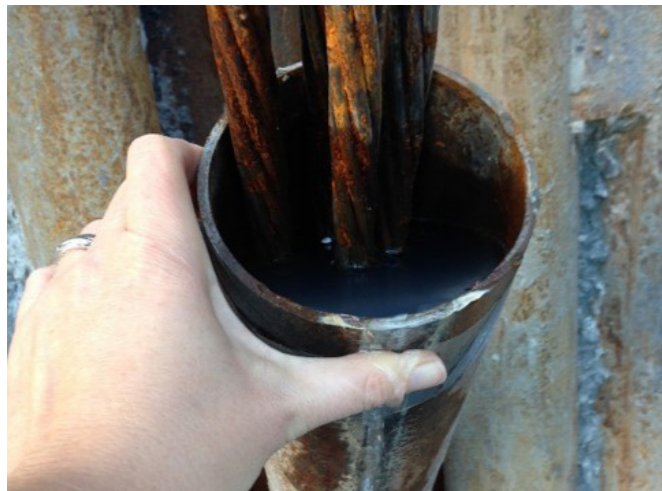
Figur 3: Lekkasje staggjennomføring innvendig
