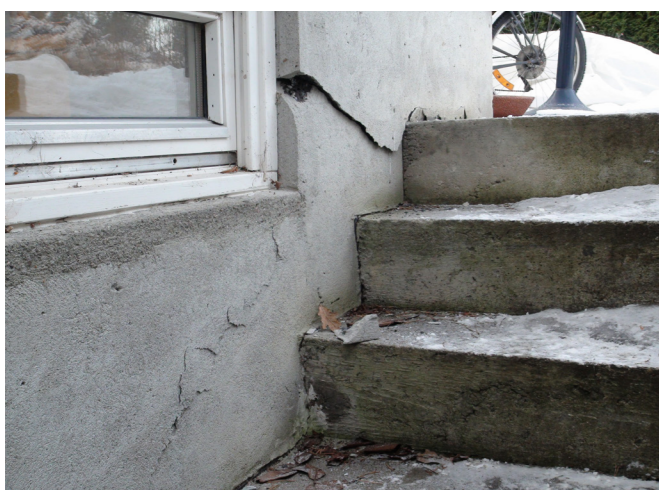
Sprengningsskade på bygning. Foto Multiconsult/Thor Watne
