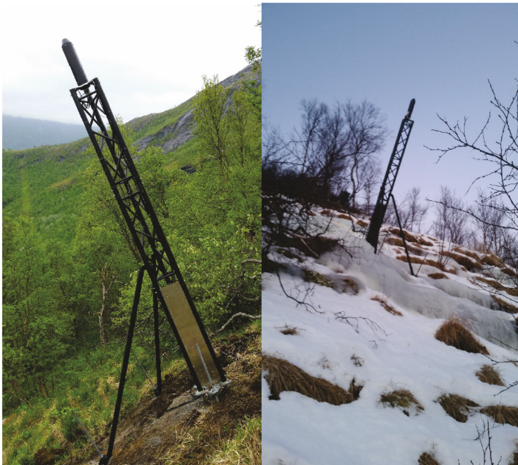
Figur 2-1 Radiomastene til skredvarslingssystemet er montert normalt på bakken, og heller derfor ca. 30 grader utover. Støttearmer og "plog" er for å beskytte mastene mot laster fra snøsig.
