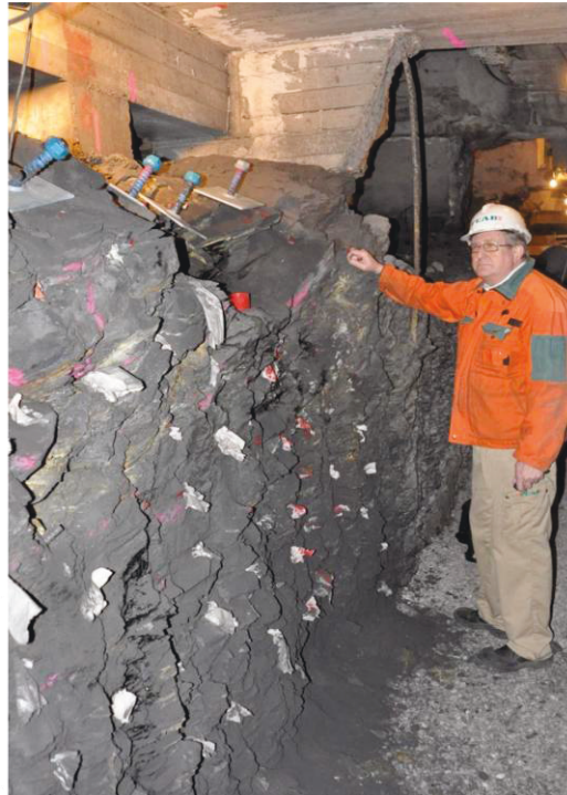
Figur 4.6-5: Forsterkning av fundament under C-fundamenter i akse 3. Skiferen ga liten motstand under meislingen. Frisk skifer er til sammenlikning vanskeligere å pigge. Informasjon og erfaringsutvekslinger med utførende entreprenør ga viktig informasjon om forvittringsgraden i skiferen og valg av løsning for å sikre stabilitet under fundamentet.
