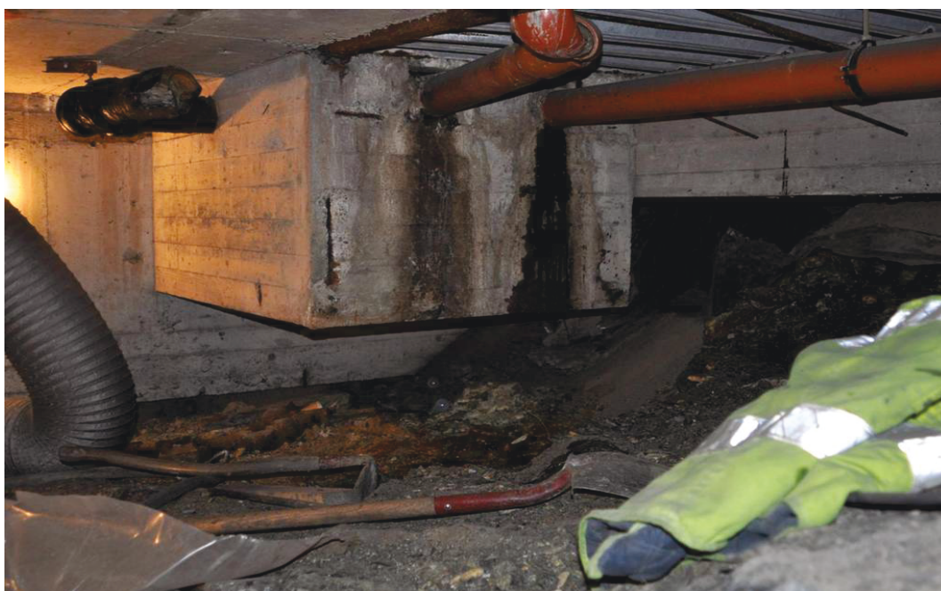
Figur 4.3-4: Etter fjerning av skifer. Ved rehabiliteringen kunne en grave ut
