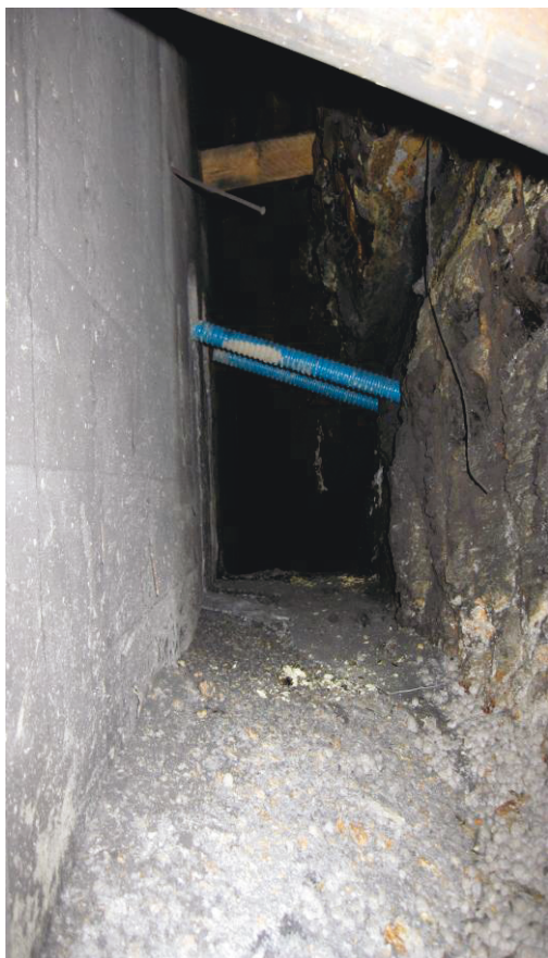
Figur 4.2-1: Grøft i akse 3 var ved oppstart (før tiltak) fylt med forvitret skifer. Grøften er på bildet halvveis fylt. Skiferen var forvitret til en finkornet masse. Skiferen vil ved volumutvidelse presse mot garasjeveggen. Blå bolter er Ischebeck stag 40/16. Foto: PEAB
