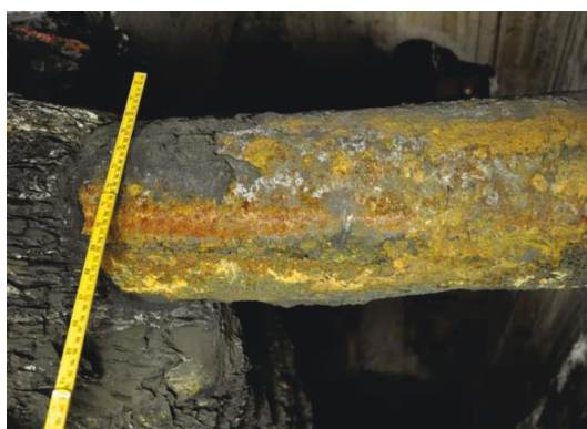
Figur 4.2-5a: Levetid/funksjonstid for sprinkler vil forlenges om røret frigjøres. Alternativt injiseres rundt røret for å fylle alle hulrom (stanse tilgang på oksygen)
