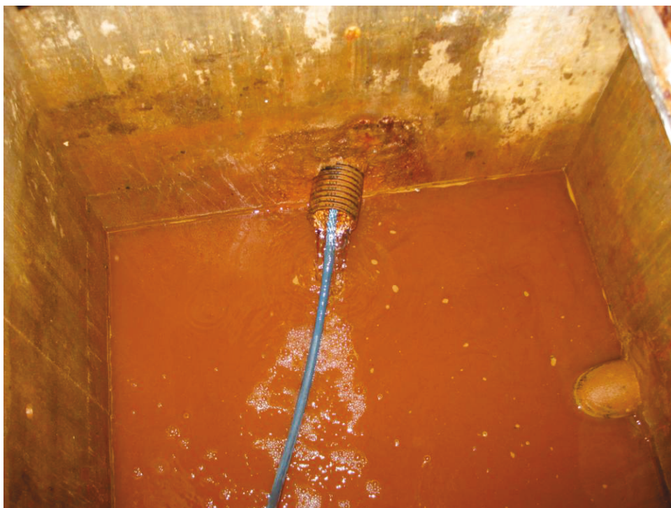
Figur 5.7-: Fargen i pumpekummen er farget av jernoksider og viser høyt jerninnhold i vannet. Dreneringen må være intakt, ellers vil risiko for skader øke.
