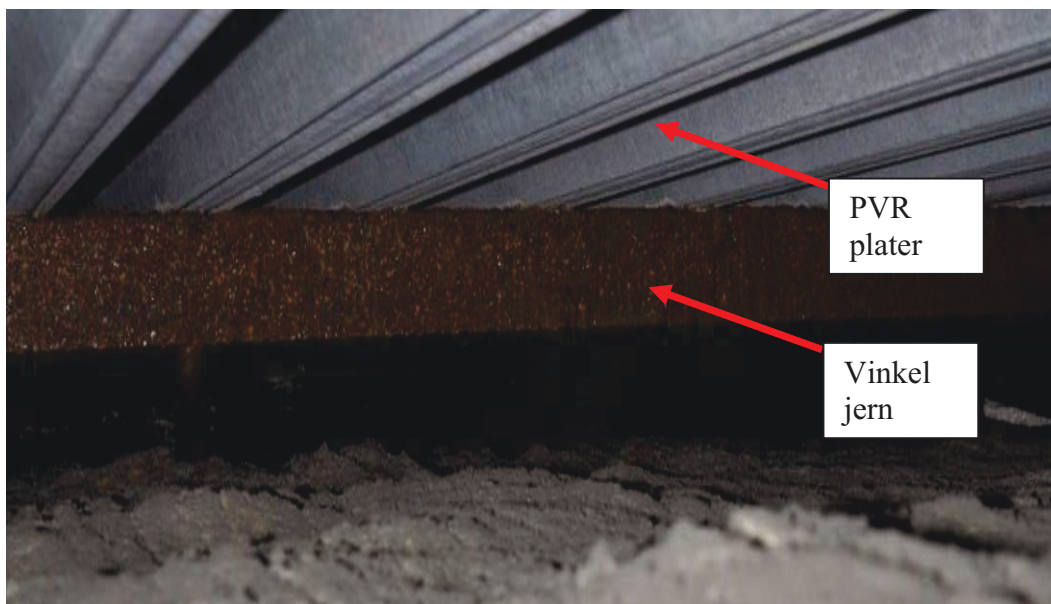
Figur 4.4-1: Bildet er tatt fra sandfang i retning mot Karl Johans gate. Flaten er ganske jevn. En oppfølging her vil med større sikkerhet fastslå når en bør vurdere tiltak. Arealet mellom akse B og akse A har en klaring på ca 10 cm til vinkeljern under PVR platene. Mellom PVR himlingen og sandlaget er det ca 20 cm. Det vil ikke bli skader på himlingen de neste 10 år. Svellingen er mest markant ved akse B og avtar i retning av akse A. Dette understøtter vurderingen av at fuktigheten er større ved akse B enn ved akse A, jfr. også observasjoner om fuktig skifer under plasten ved akse B.
