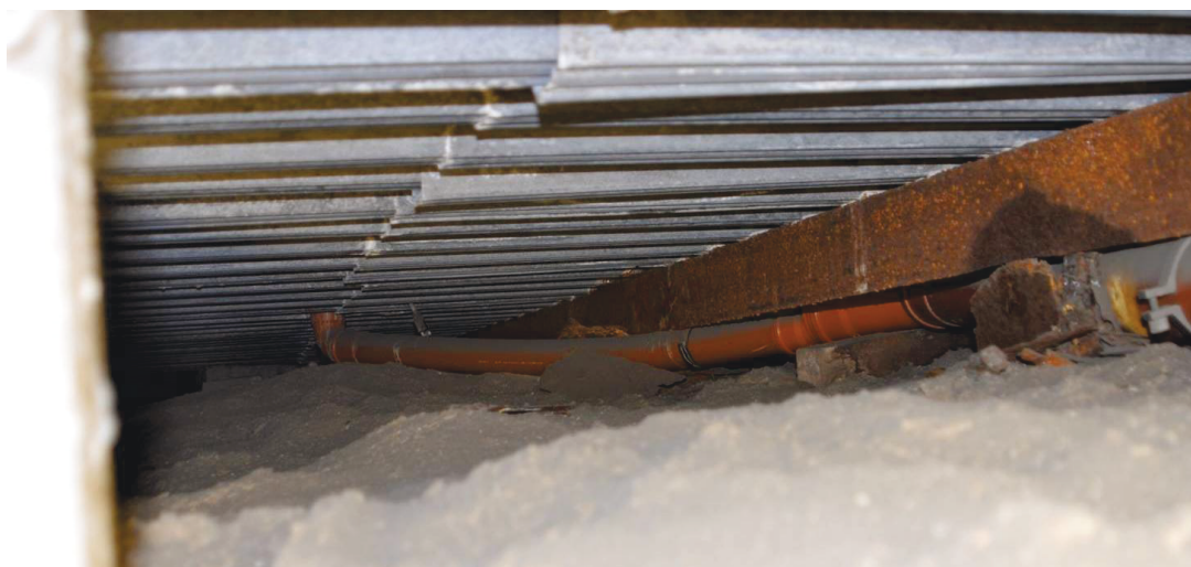
Figur 4.4-2: Areal 4.4 mellom A2-B3. Rørene ligger i klem som følge av svelling. Opphengspunkter er også påvirket. Det er ikke tilstrekkelig fri åpning til å kripe inn her. Dette er det eneste røret som er observert ved lokalitet 3. Det kommer ned omtrent halvveis mellom akse B og akse A. Akse 3 til venstre for bildet. Rørene er koblet fra.
