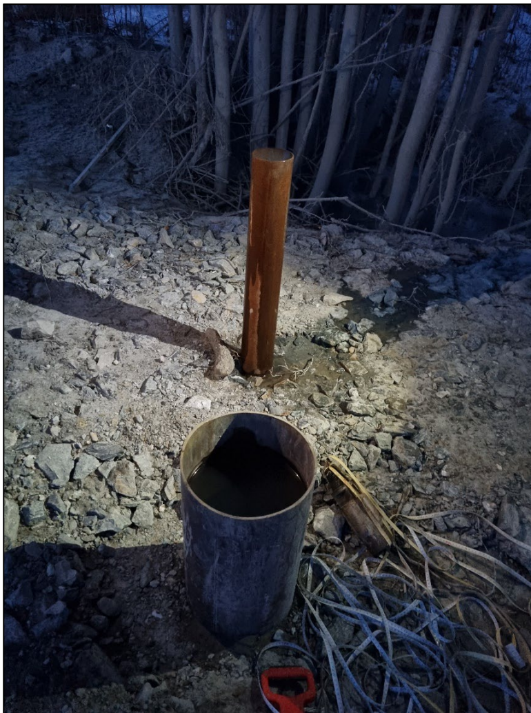
Figur 4-6: Ferdig installert \varnothing 323 mm pel og \varnothing 139 mm pel. Ca. c/c 1 meter mellom pelene. Det ble observert rennende vann over kanten av røret til den lille pelen noe tid etter boring var avsluttet (10. desember 2021).
