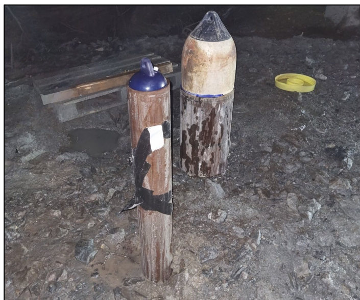
Figur 4-9: Kvelden 15. desember ble det blåst opp "fender ballonger" i rørene. Disse stoppet strømmingen. Blå tusj markerte plasseringen ved installasjon. Ny kontroll viste ingen forflytning dagen etter.
